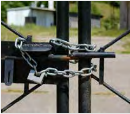
Poškozené díly vrat
