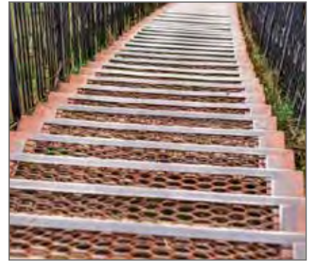
Opotřebované kovové schodiště
